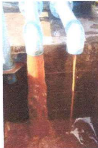
Ilustración 3: Desague del proceso de floculación y sedimentación
