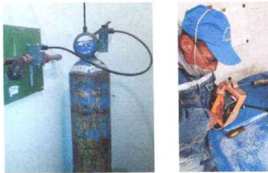
Ilustración 2: Precloración por medio de cloro gas y bomba en mal estado
