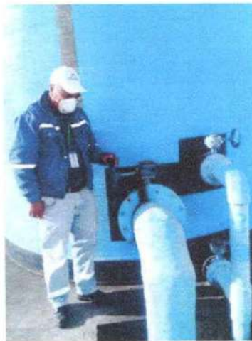
Ilustración 4: Volante del filtro dañado
